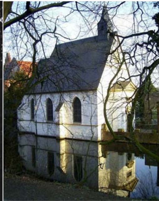
Feuchtigkeitseinwirkung vor Sanierung
